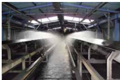
Il PLC arresta immediatamente il nastro trasportatore ed avvia il sistema di estinzione a pioggia sprinkler non appena viene attivato l'allarme di temperatura.
