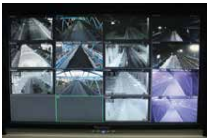
Le immagini e i dati termici provenienti da sette termocamere FLIR vengono inviate al PLC ed alla sala di controllo.
