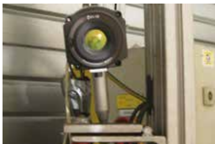
Questa termocamera FLIR è utilizzata per controllare l'impianto di condizionamento dell'aria.
