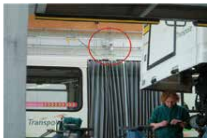
Le termocamere FLIR sorvegliano costantemente l’intero sito.
