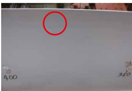
Inclusione rilevata sulla coda della pala.
