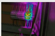
Fig.3: Collegamenti elettrici allentati
